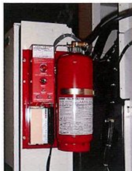
自動消火装置
